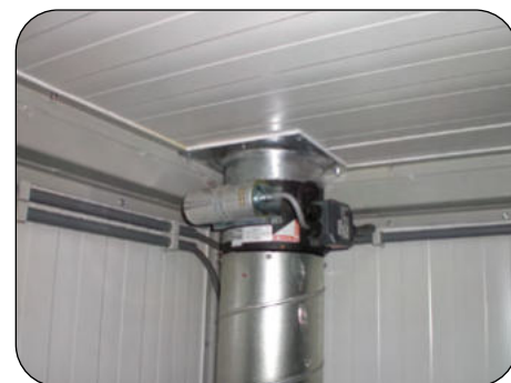
Abluftkanal mit K-90 Absperrvorrichtung
