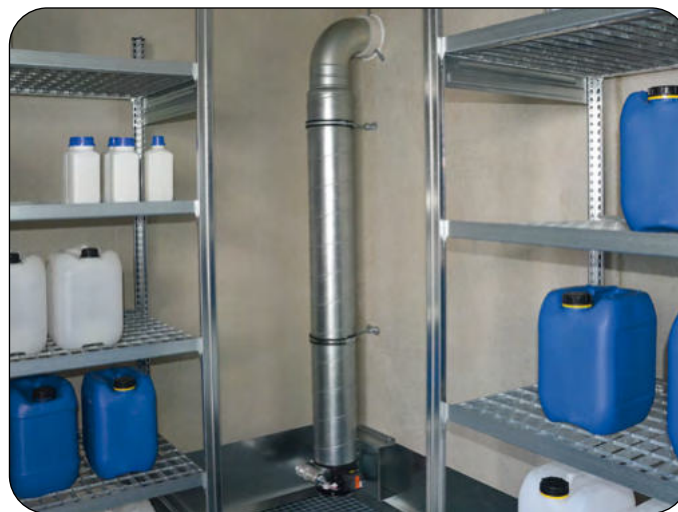
Ex-Abluftanlage inkl. Abluftkanal bis Auffangwanne
