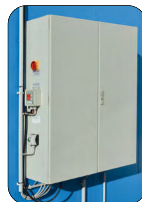
Schaltschrank mit zentraler Steuerung und Bedienelementen
