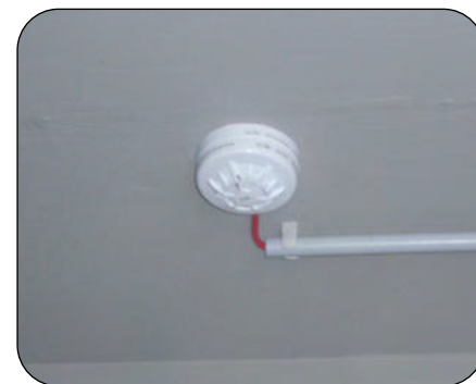
Wärmemelder zur Ansteuerung der Türfeststellanlage
