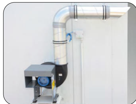
Ex-geschützter Abluftventilator inkl. Abluftüberwachung
