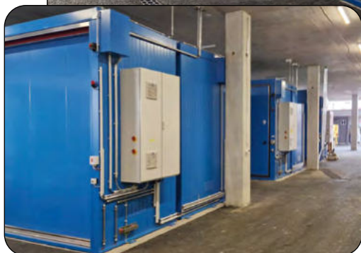
◆ Brandschutzcontainer wurden im Gebäudekomplex (Erdgeschoss) integriert
