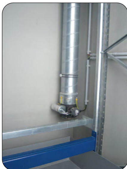
Ex-Abluftanlage inkl. brandgeschützter Lüftungselemente
