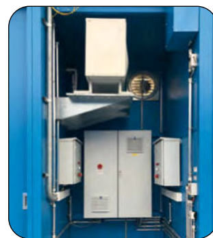
◆ Zentrale Steuereinheit (Schaltschrank, E-Unter-verteilung, Kühlaggregat)
